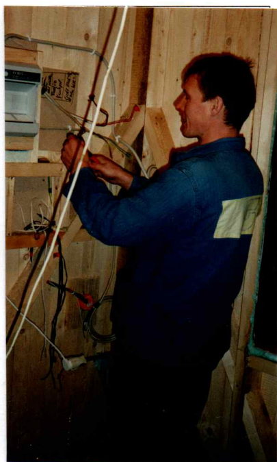
Joni entknotet den Kabelsalat.
